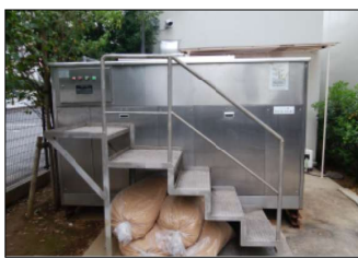
残渣処理施設
