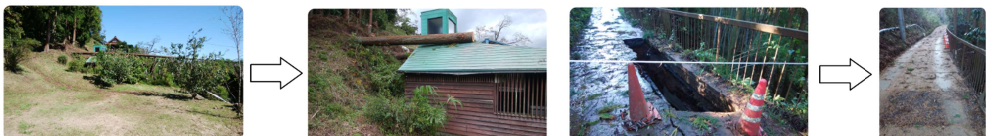
梅郷4丁目旧都立天満公園の倒木の処理現場 和田町2丁目、並木入林道の陥没と復旧後の状況
